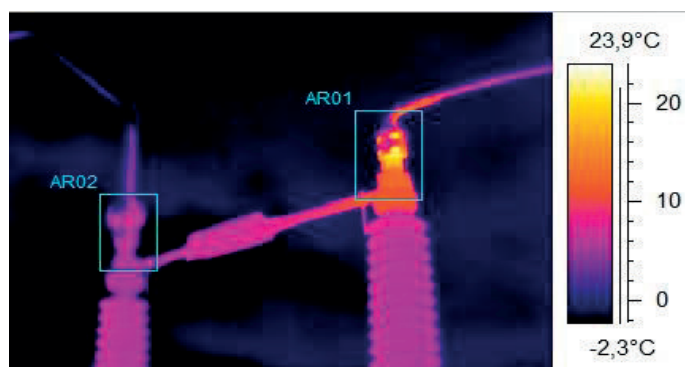
Slika 7: Termogram linijskog rastavljača [3]
